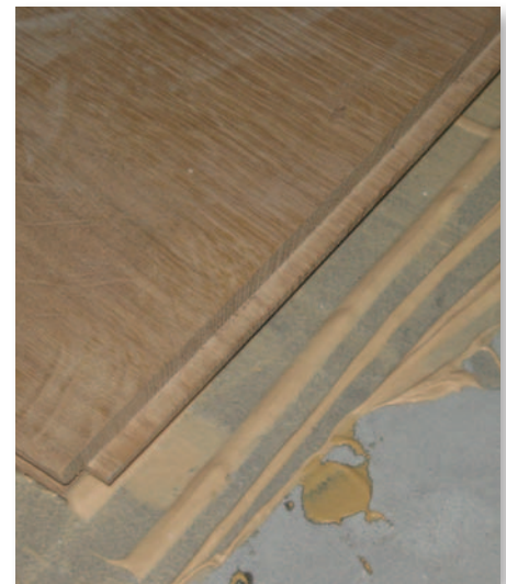
Fig. 1 La nature de la colle a une réelle influence sur l'isolement aux bruits de choc des planchers
