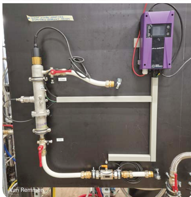
2 Poste d'essai équipé d'un système d'ultrafiltration (en haut) et d'un système de traitement par ultraviolets (en bas).
