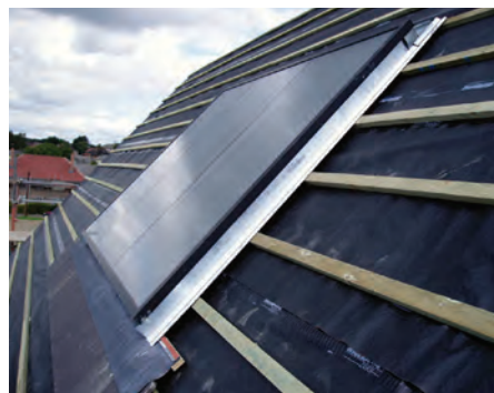
Afb. 2 Integratie van zonnecollectoren in hellende daken.
