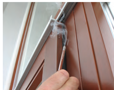
Afb. 2 Lokalisering van een lek met een spoorgas.
