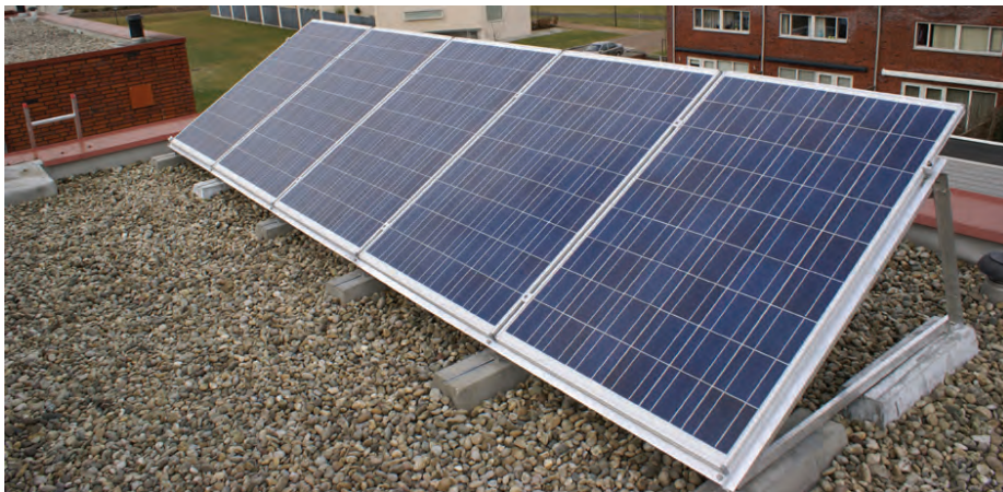
Afb. 3 Het rendement verhoogt door een goede verluchting van de achterzijde.
