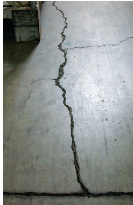
Scheurvorming in een industriële betonvloer.
