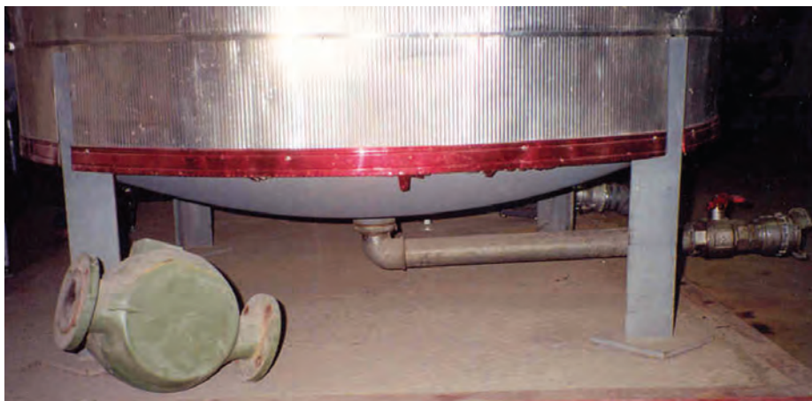
Afb. 2 Niet-geïsoleerde warmwatertanks vertonen een groot risico op legionellaontwikkeling.
