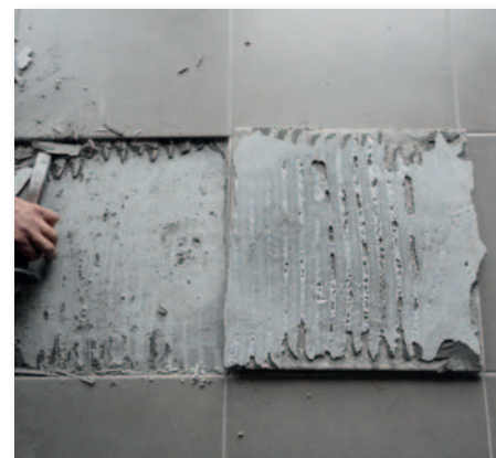
Afb. 2 Ettringietvorming in de mortellijm.
