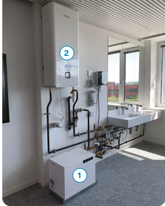
2 Proefpost waarin de prestaties van een PCM-batterij (1) vergeleken worden met die van een geëmailleerde elektrische boiler (2).
