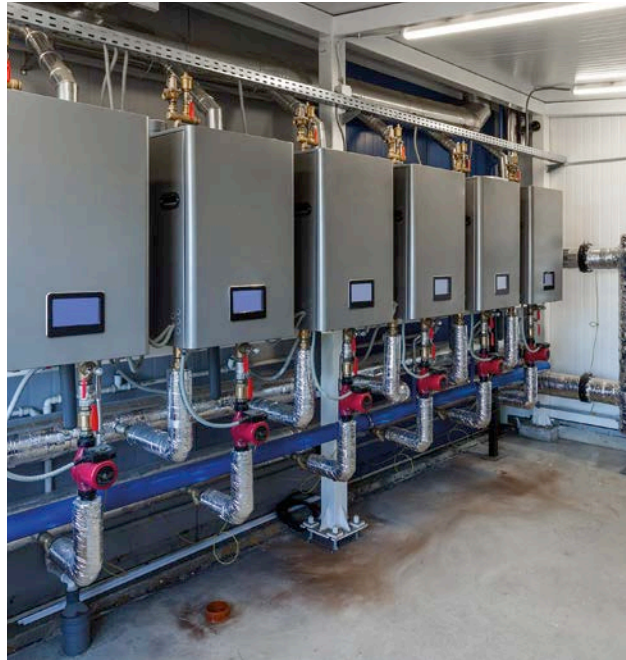
1 Chaufferie abritant plusieurs chaudières montées en cascade.
