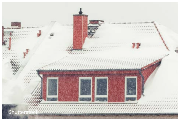
2 Accumulation de neige au pied des lucarnes.
