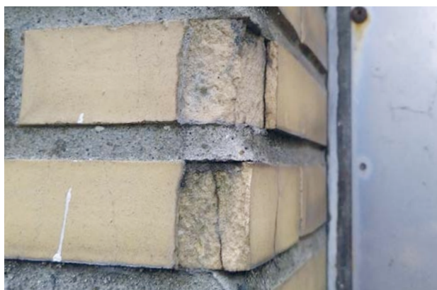
4 Briques endommagées par le gel.
