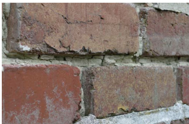
3 Dégradation très importante du mortier de pose causée par le gel.
