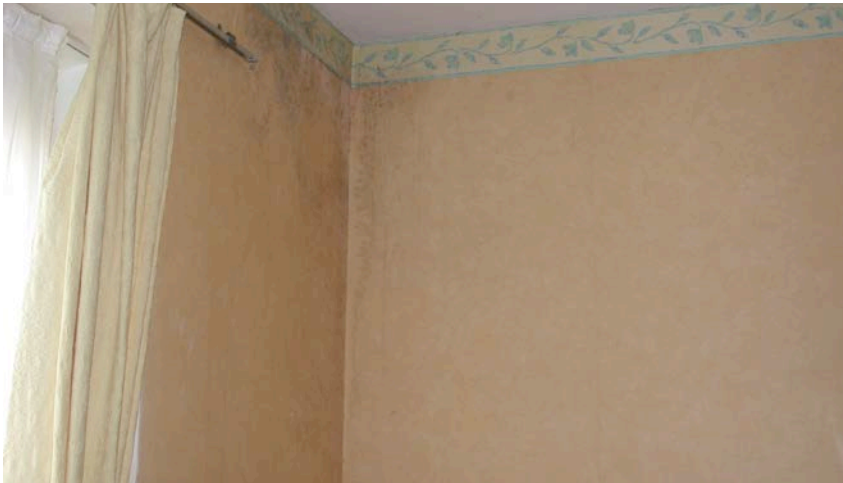
3 | Schimmelvorming op de binnenafwerking
