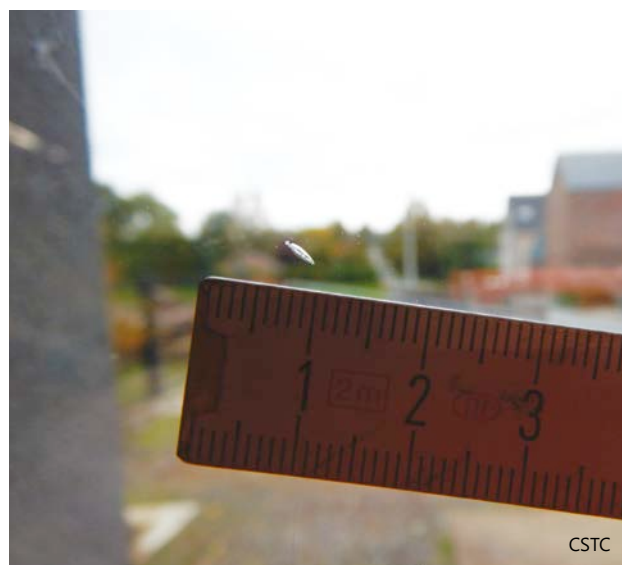
2 | Défaut linéaire (admissible).
