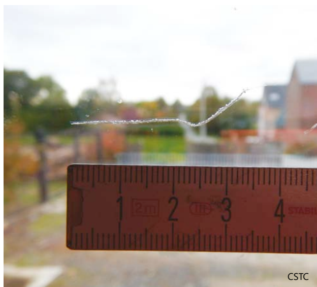
1 | Défaut linéaire (non admissible).
