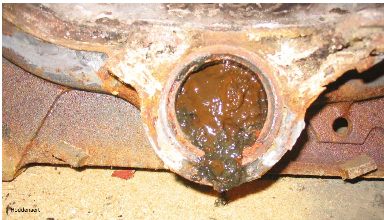
1 | Dépôts dus à la corrosion au sein d'une installation de chauffage central.
