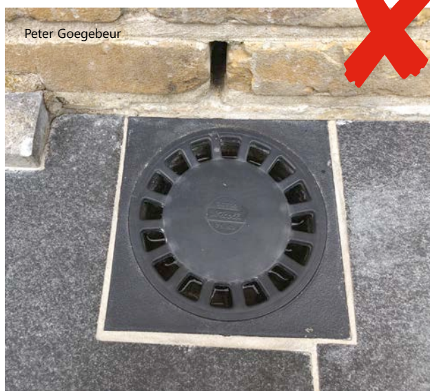
1 | Joint asymétrique autour d'un avaloir (non acceptable).
