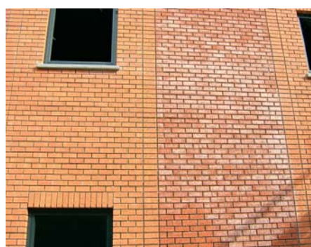
Gebäude, bei dem Salzausblühungen auf rotem Backstein vorkommen, jedoch nicht auf orange.
