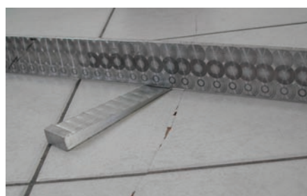
Abb. 3 Krümmung der Gesamtheit von Estrich und Fliesenbelag.
