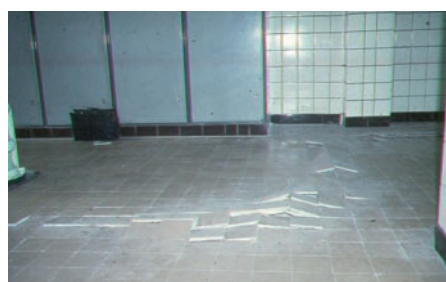
Abb. 1 Abheben eines Fliesenbelags auf einem stabilisierten Sandbett.
