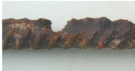
Lochfraßkorrosion durch Chloride.
