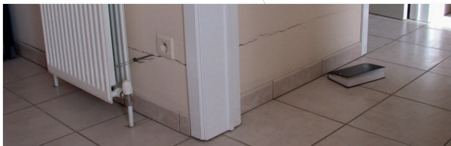
Afb. 1 Scheurvorming in een niet-dragende binnenwand op de verdieping van een appartementsgebouw
