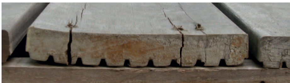
Afb. 1 Scheurvorming ter hoogte van een bevestiging
