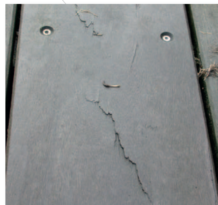
Afb. 2 Afschilfering van het houtoppervlak
