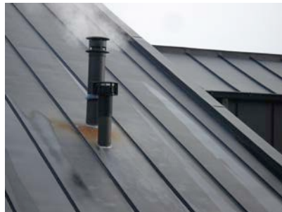
1 | Bruine vlek- vorming op een dak in de buurt van het rookgasafvoerkanaal van de verwarmings- ketel
