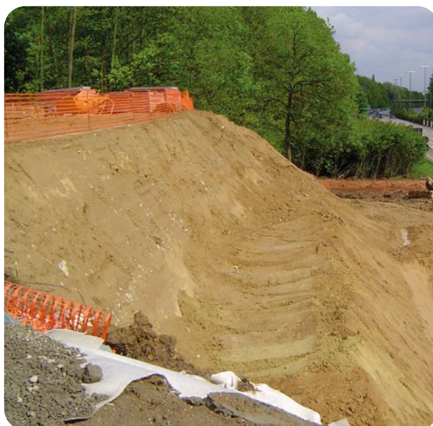
2 Réalisation d'une berme en milieu de talus pour en augmenter la stabilité et en faciliter l'entretien.
