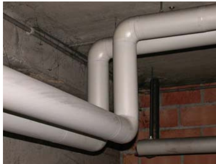
Abb. 1 Wärmeisolation der Rohrleitungen, die sich außerhalb des geschützten Volumens befinden.
