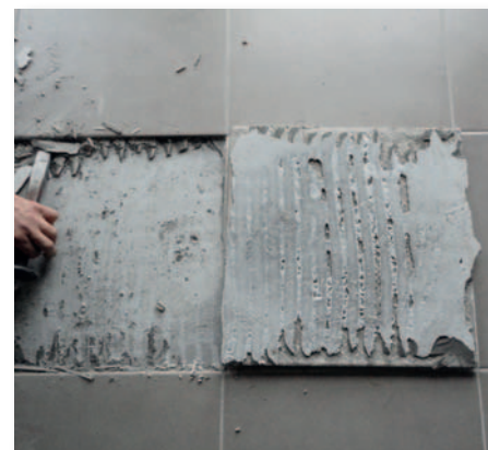
Abb. 2 Ausbildung von Ettringit in einem Mörtelkleber.
