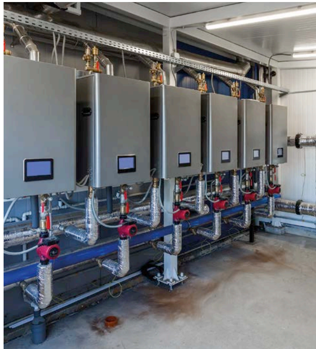
1 Stookplaats met verschillende stookketels (cascade).
