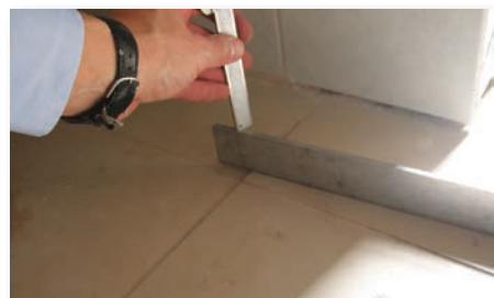
Fig. 1 Mesure du désaffleurement réel entre deux carreaux adjacents
