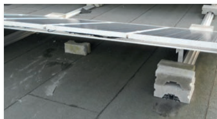
Fig. 1 Glissement de l'installation photovoltaïque
