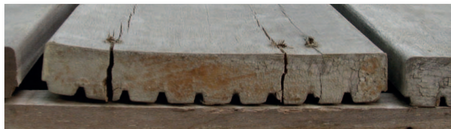
Abb. 1 Rissbildung im Bereich der Befestigungspunkte.
