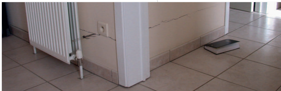
Abb. 1 Rissbildung in einer nicht tragenden Wand auf der Etage eines Wohngebäudes.
