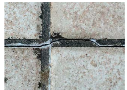
3 | Risse durch hygrothermische Ausdehnungen und/oder Bewegungen des Untergrunds
