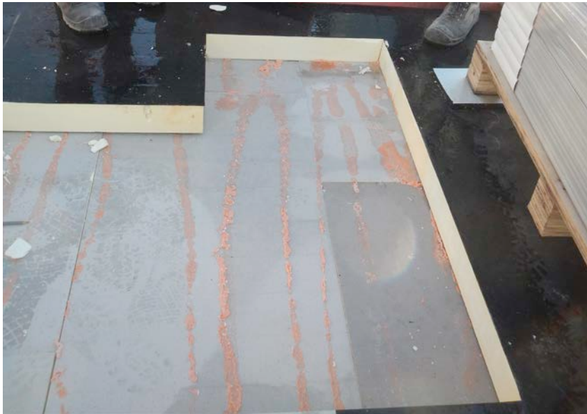
2 | Die Verteilung der Feuchtigkeit im Dachaufbau erschwert es, den Ursprung der Infiltrationen zu ermitteln.
