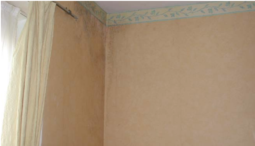
3 | Schimmelbildung auf der Innenverkleidung
