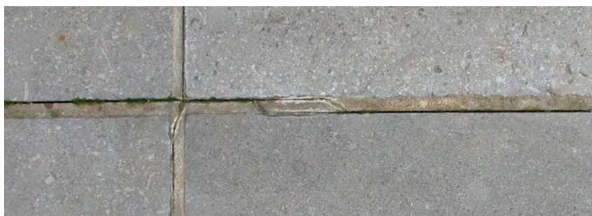
1 | Microfissures au sein des joints d'un dallage en pierre naturelle
