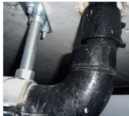
Afb. 3 Condensvorming op een hemelwaterafvoerleiding
