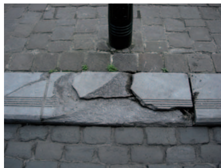
Afb. 2 Verzwakte en gebroken boordstenen uit kalksteen.
