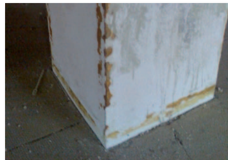
Roestplekken tengevolge van corrosie
