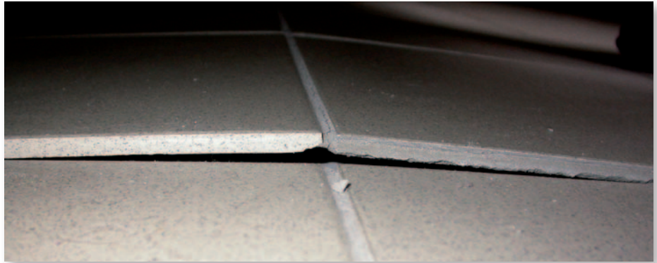
Afb. 1 Loskomen en omhoogkomen van de tegels na een te snelle opstarting van de vloerverwarming
