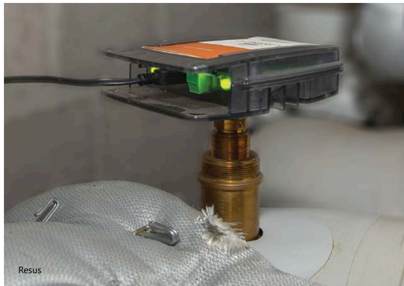
2 | Monitoring van de corrosievorming in verwarmingssystemen.
