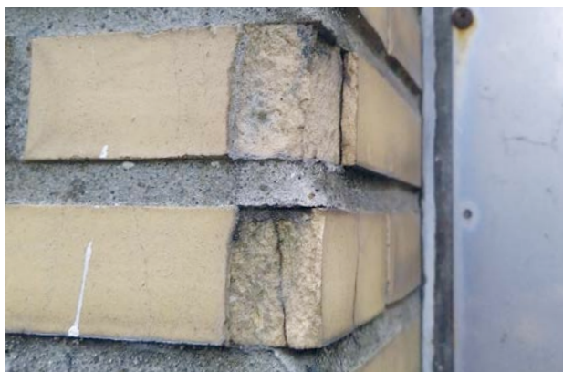
4 Vorstschade aan bakstenen.
