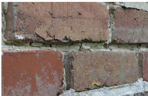
3 Aanzienlijke vorstschade aan de plaatsingsmortel.
