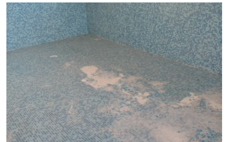
Ablösung von kleinen Mosaikfliesen in einem Schwimmbad.
