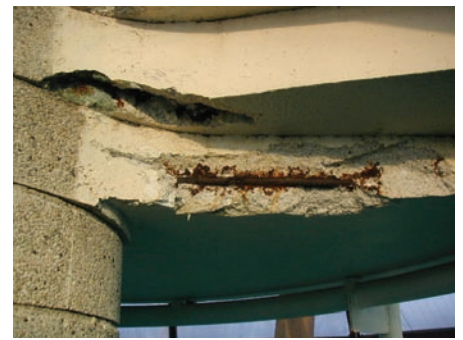
Afb. 2 Corrosie van de betonwapening.
