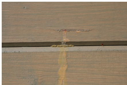
Afb. 1 Harslekken doorheen de afwerking.
