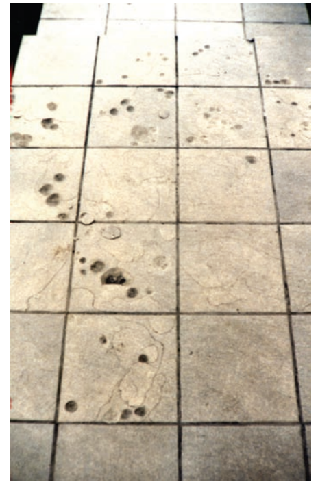
Abb. 5 Frostscha den an einer Außenterrasse.
