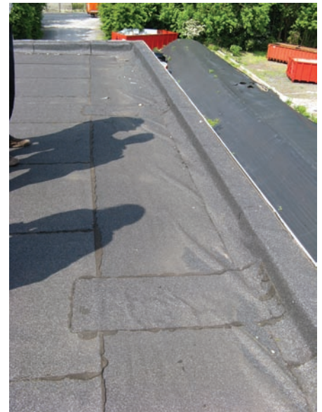
Abb. 1 Faltenbildung in der Dachabdichtung.
