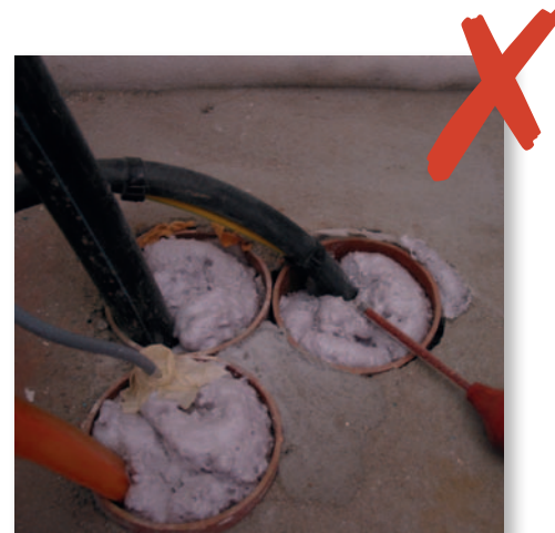
Afb. 5 Gebruik van mantelbuizen die niet afgestemd zijn op de diameter van de leidingen.
