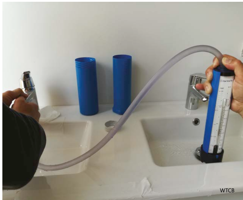
2 | Meting van het spoeldebiet aan een tappunt.
