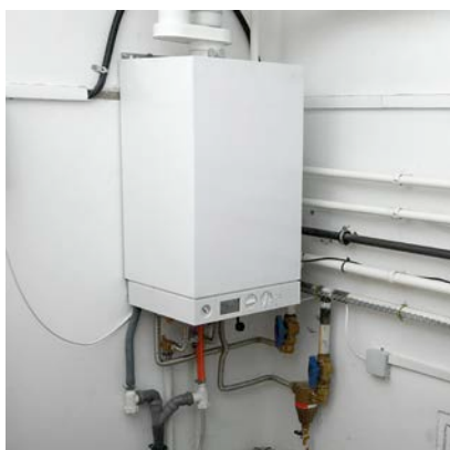
1 | Centrale warmtegenerator: ketel
