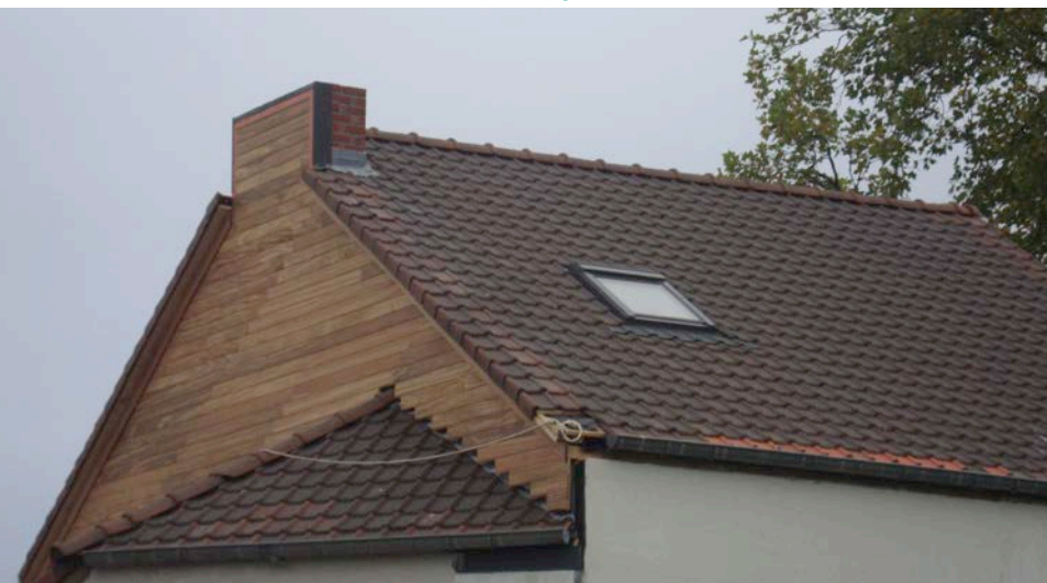
3 | Gelet op het feit dat dit huis enkele jaren na de renovatie van het dak langs de buitenzijde geïsoleerd werd, zijn er kleurverschillen waarneembaar ter hoogte van de dakranden en de onderkant van het dak.
