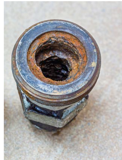
4 | Dépôts d'oxyde de fer dans les canalisations
