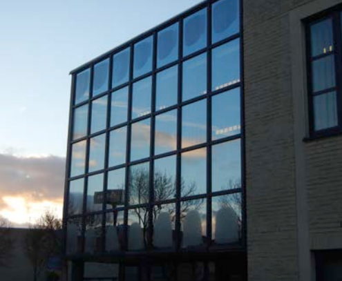
3 et 4 | Formation de condensation superficielle en partie centrale de panneaux d'allège vitrés (à gauche) ou d'éléments de bardage métallique avec isolation thermique intégrée (à droite)
