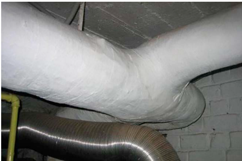
4 | Das Vorhandensein und der Zustand der Dämmung müssen überprüft werden.
