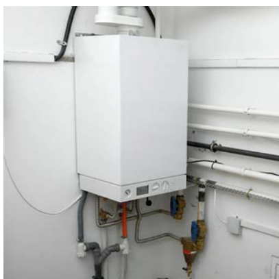
1 | Zentraler Wärmeerzeuger: Kessel.
