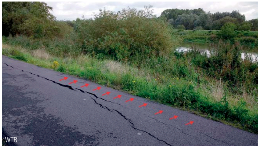
1 | Rissbildung in einem instabilen Deich entlang der Schelde, in Melle.
