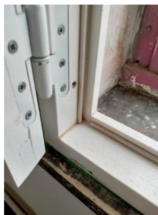
FIGURE 7 – DISCONTINUITÉ DU JOINT ENTRE LE DORMANT ET L'OUVRANT
