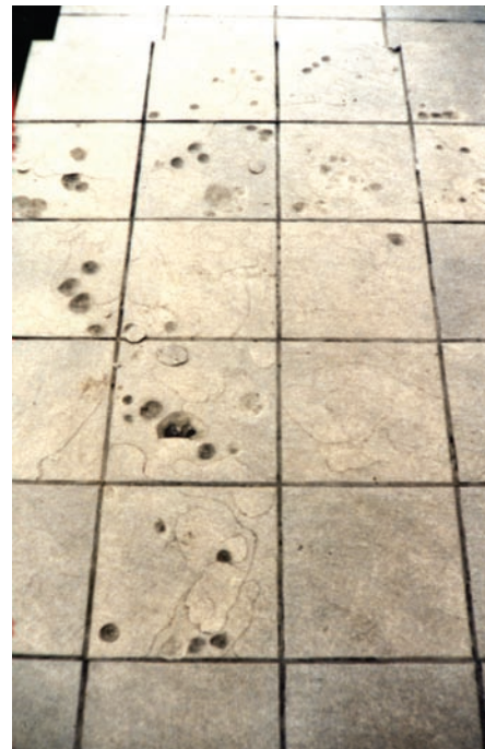
Afb. 5 Vorstschade op een buitenteras.
