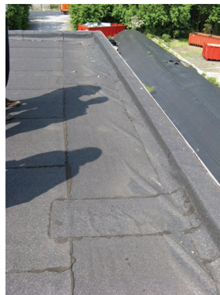
Afb. 1 Rimpelvorming in de dakafdichting.
