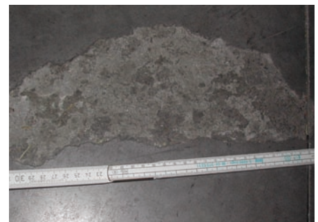
Afb. 4 Loskomen van de slijtlaag van een betonvloer.
