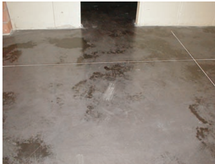
Afb. 2 Kleurverschillen door resten van curing compound.
