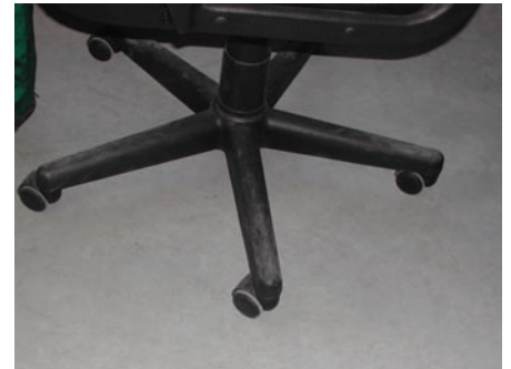
Afb. 3 Stofaggifte bij een pas gestorte betonvloer.
