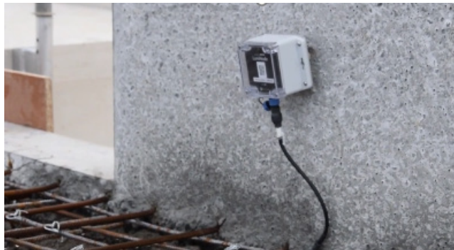
Fig. 4: Sensor om het moment van ontkisten van een betonplaat te optimaliseren
