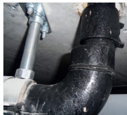
Fig. 3 Condensation sur une conduite d'évacuation d'eaux pluviales
