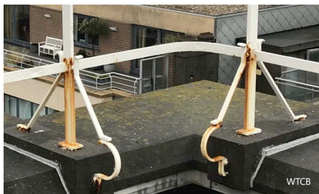
4 | Corrosievorming ten gevolge van een overblijvende chlorideverontreiniging.
