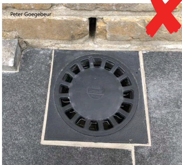
1 | Asymmetrisch voegbeeld rondom een afvoerkolk (niet aanvaardbaar).
