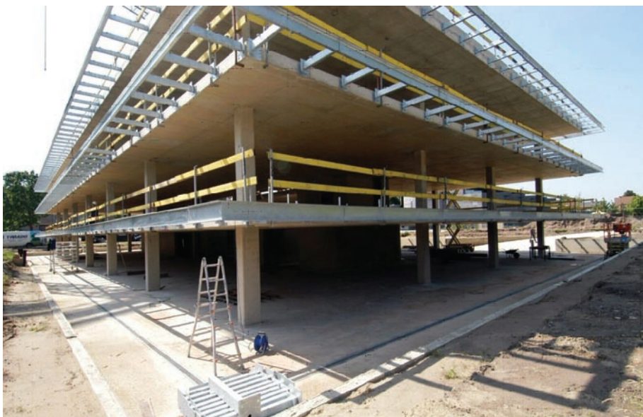
Demontierbare Fassade, Synonym für Flexibilität.
