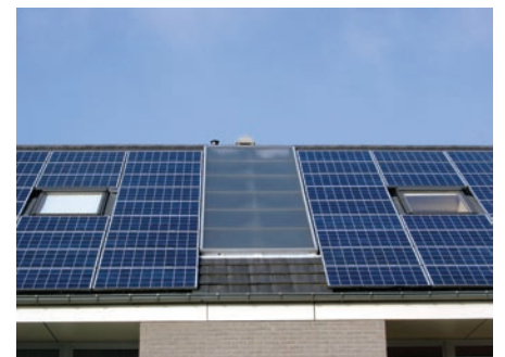
Integration von Solarenergietechniken in ein Dach.
