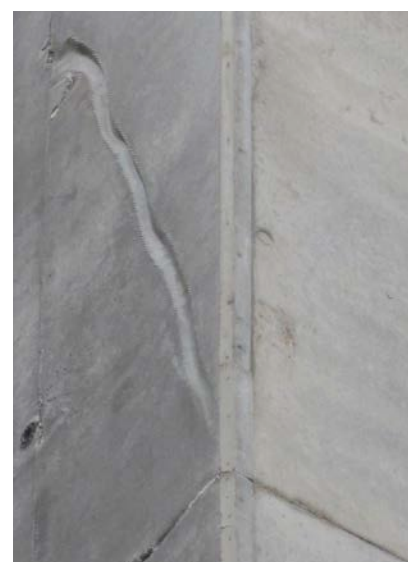
4 | Abdruck an der Betonoberfläche durch die Faltung eines sich gelösten CPF-Liners.
