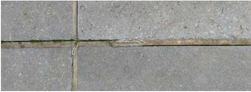
1 | Mikrorisse in den Fugen eines Bodenbelags aus Natursteinplatten.
