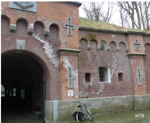
1 | Salzausblühungen, die beim Trocknen einer Wand nach Feuchtigkeitseintritt entstehen.
