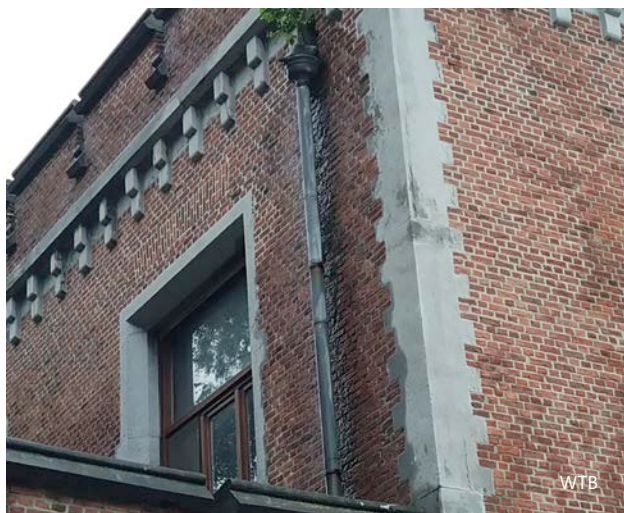
3 | Feuchtigkeits Eintritt infolge eines schlecht instand gehaltenen Regenfallrohrs.
