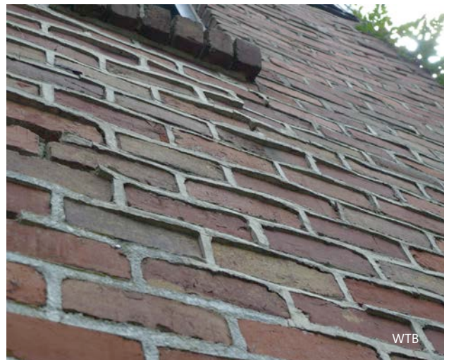
2 | Herausdrücken von Fugen aufgrund von gefrierendem Mauermörtel.
