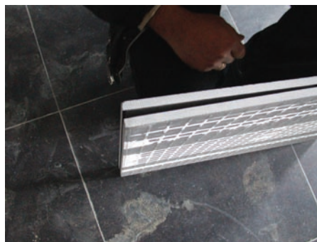
Fig. 1 Ecart de planéité important d'un carreau céramique.
