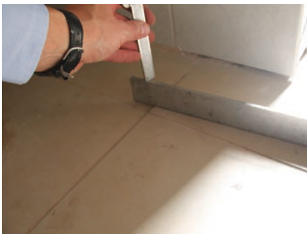
Fig. 5 Mesure du désaffleurement entre deux carreaux adjacents.
