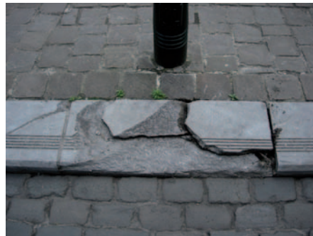
Abb. 2 Versprödete und gebrochene Kalksteinkanten.
