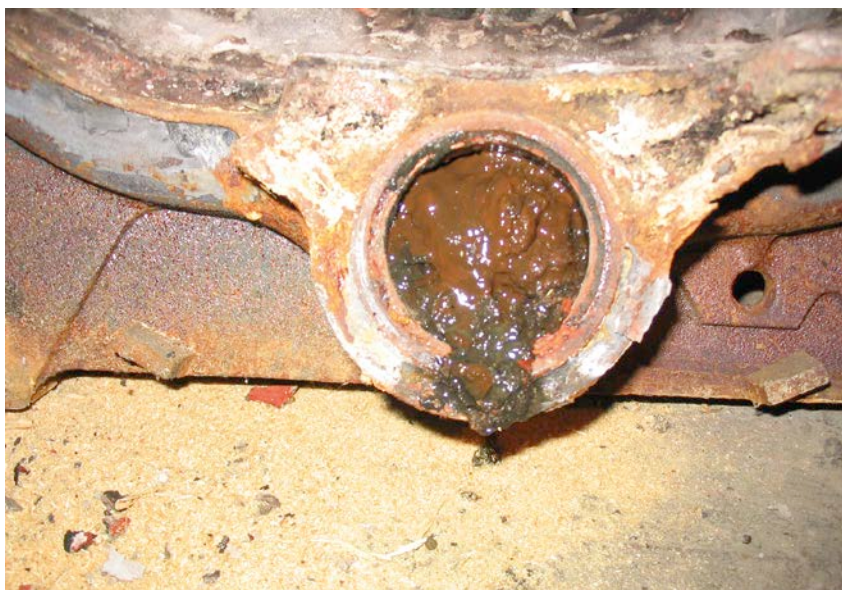
Afzettingen in een verwarmingsinstallatie.
