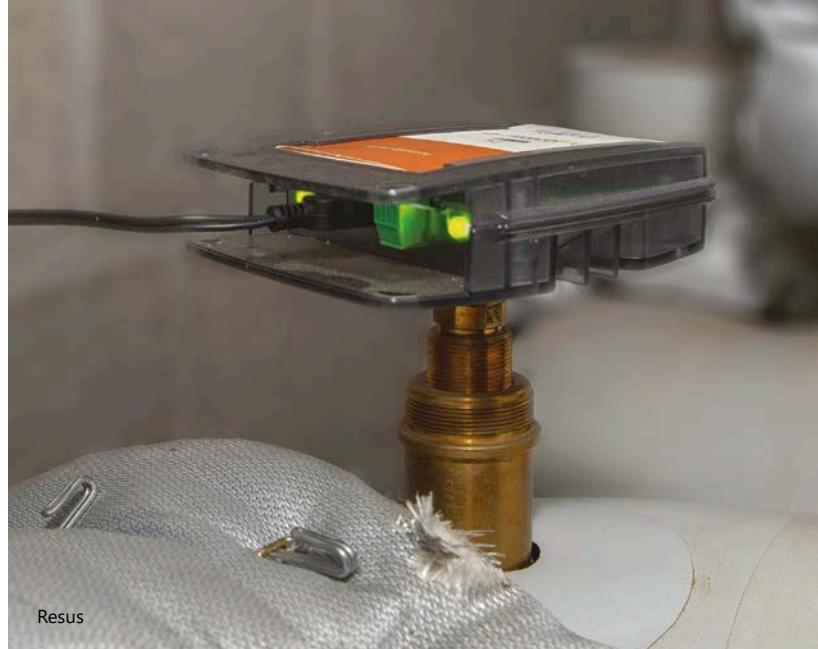
2 | Monitoring de la corrosion dans un système de chauffage.
