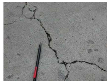
Fig. 2 Fissures de retrait plastique.
