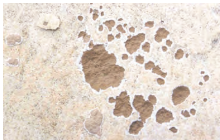
Fig. 1 Exemple d'un dégât de gel observé.
